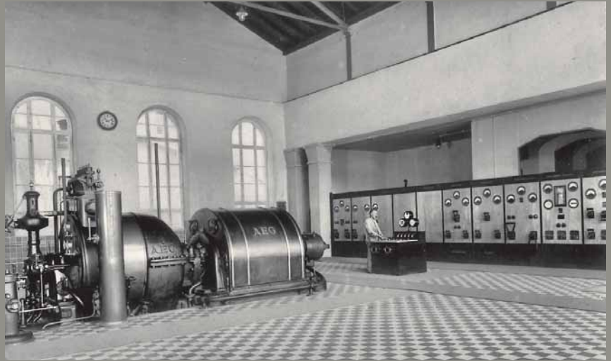
KONDENSATIONSTURBINE MIT DREHSTROMGENERATOR der Firma AEG mit einer Leistung von 1600 KW, 1928
